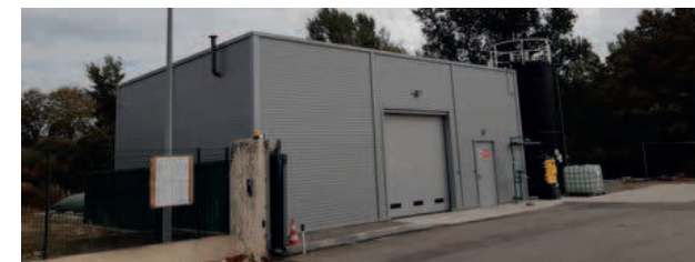
Unité d'affinage des eaux traitées par ultrafiltration sur le site de l'usine de Ginestous Garonne
