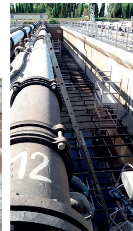
Bassin d'aération G1
